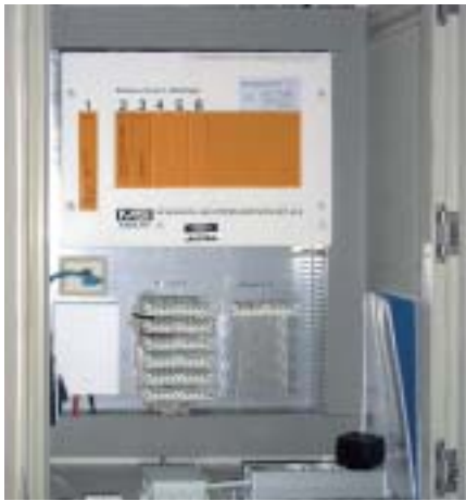
Das ISDN-Übertragungsgerät DIGIFON MSD 4010 erfasst Alarmer und technische Meldungen und überträgt sie zur Feuerwehr bzw. zur ELTPLAN-Leitstelle und den Serviceunternehmen
